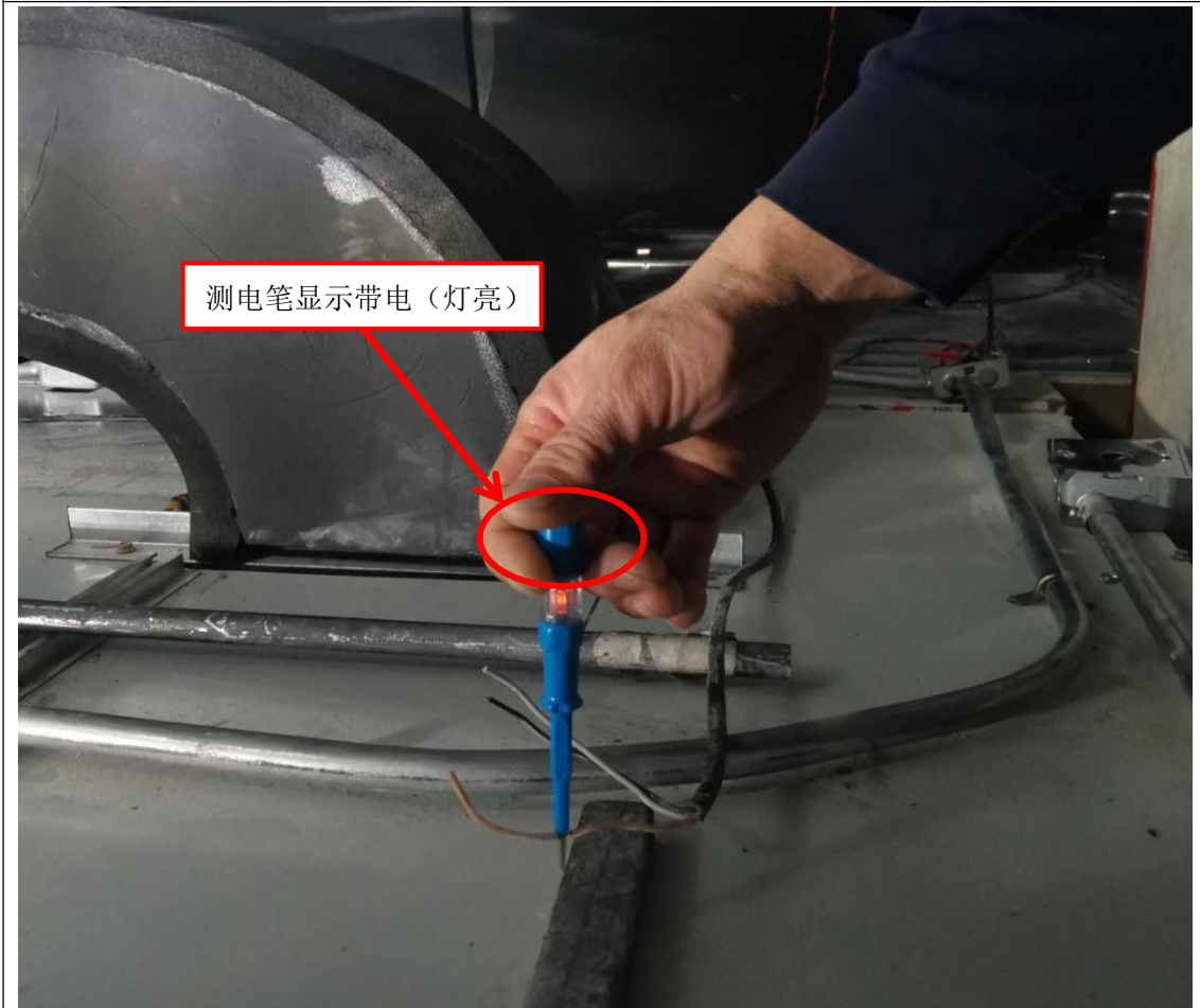
图 3 测电笔测量裸露的线缆显示带电
