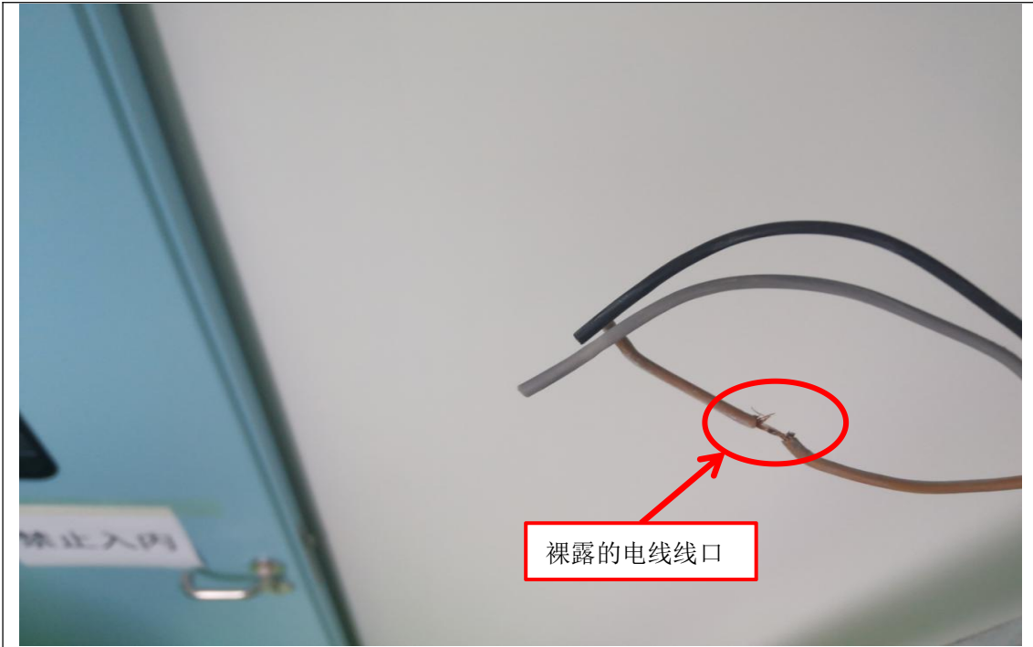
图 2 事发位置裸露的电线线缆
