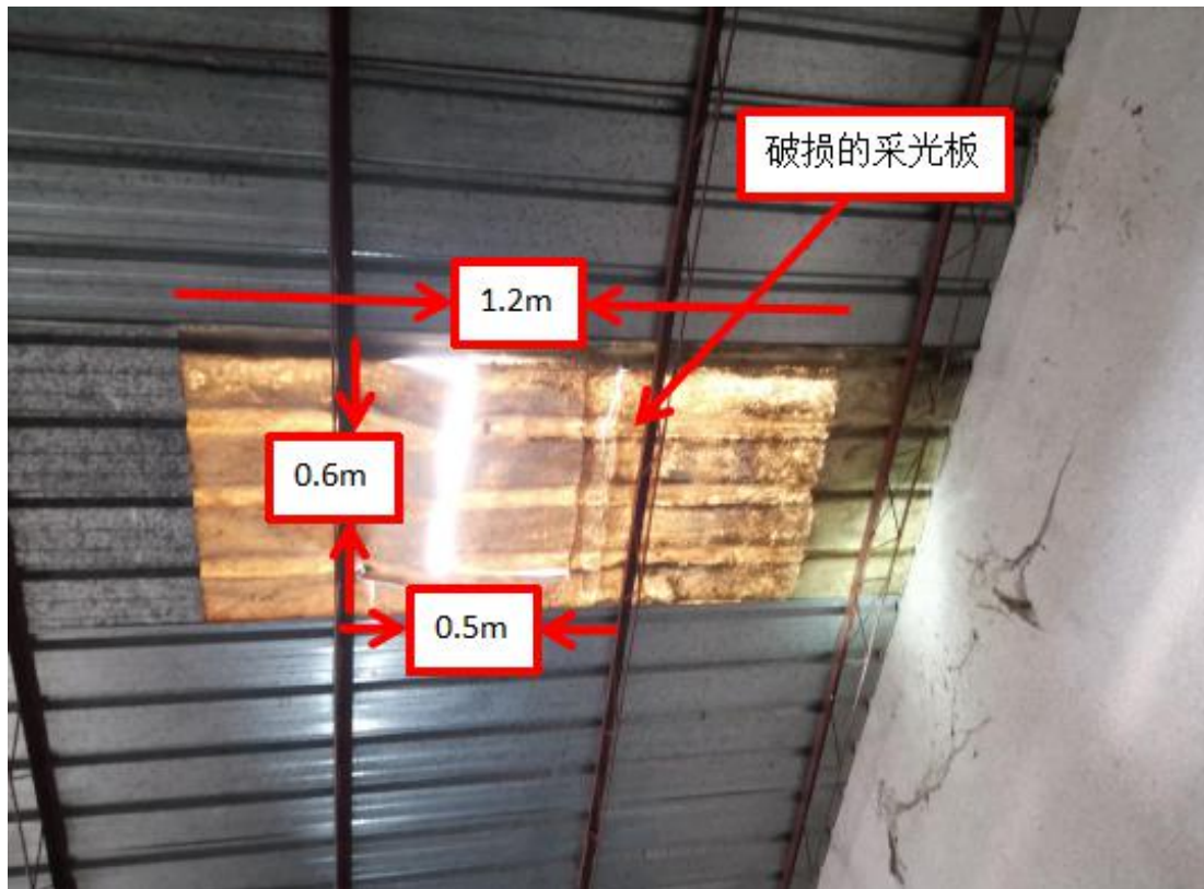
图三 事发铁皮顶厂房采光板情况
